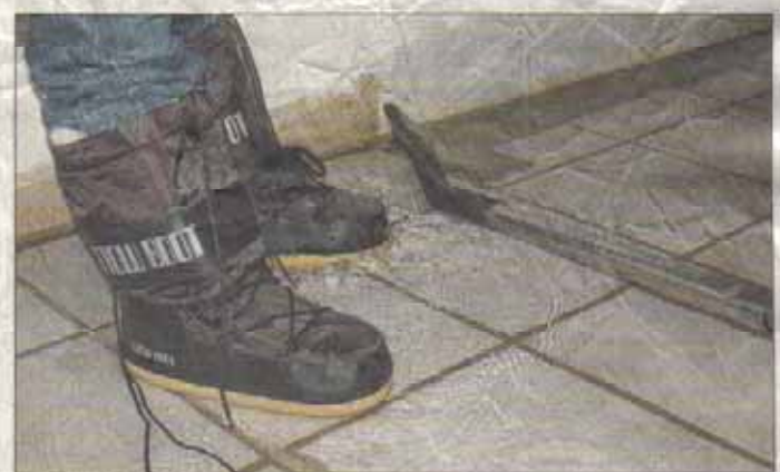
In diesem Holzbüttgener Keller schwimmen keine Krokodile, aber das Wasser macht die Räume unbewohnbar. Foto: Schmitz
