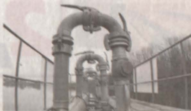
Trotz Pumpen steigt das Wasser weiter in die Keller der Häuser. NGZ-FOTO: L. BERNIS
